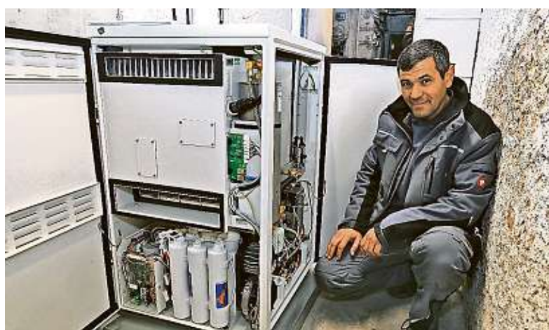
Kaum größer als ein Kühlschrank ist das Mikrokraftwerk, das Enver Karahan von der gleichnamigen Haustechnik-Firma in Brötzingen installiert hat. FOTO: KETTERL
